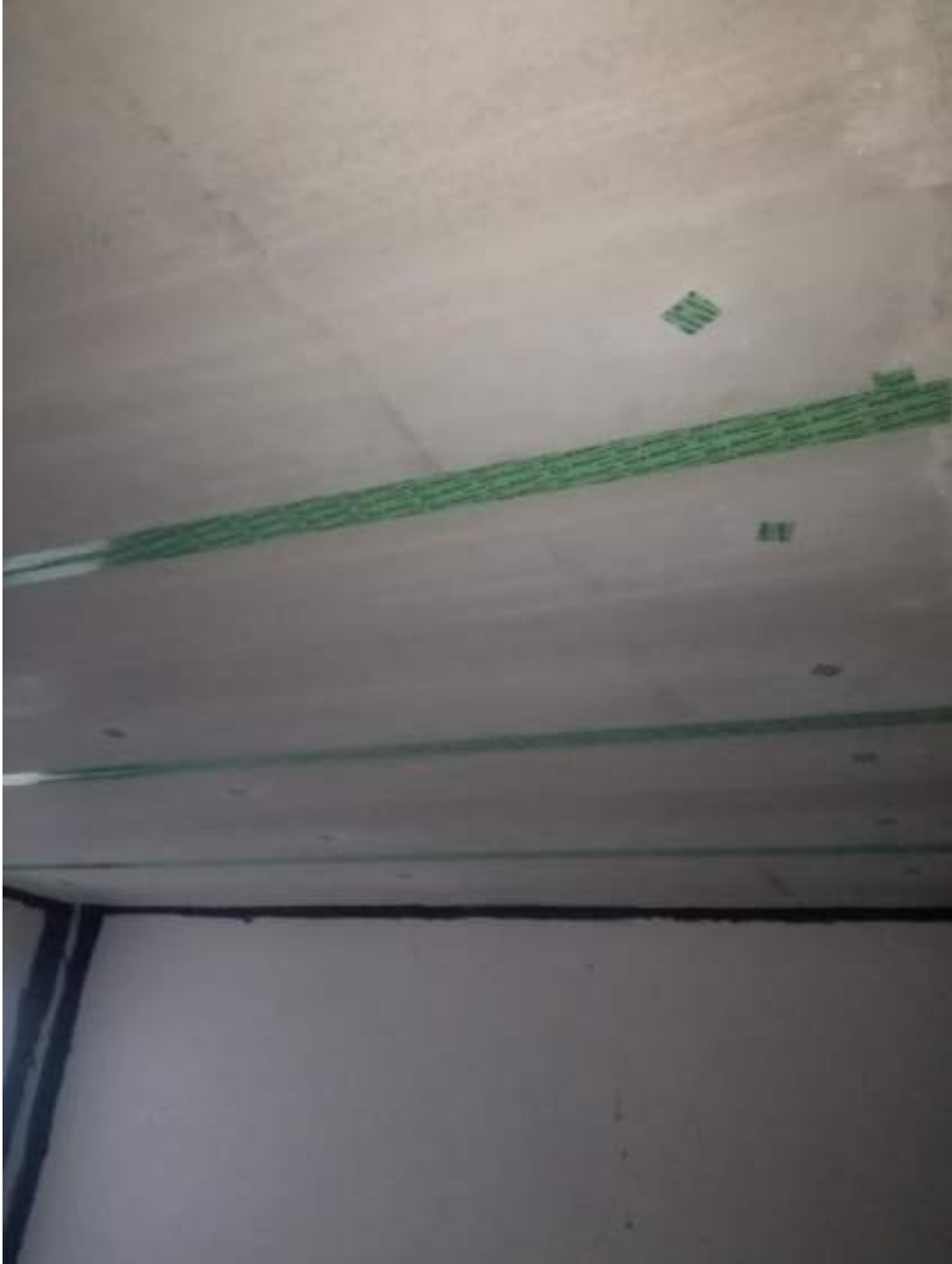
Ilustración 8 Prelosas pretensadas PRZ vna con juntas selladas mediante cinta específica Siga Rissan 100
