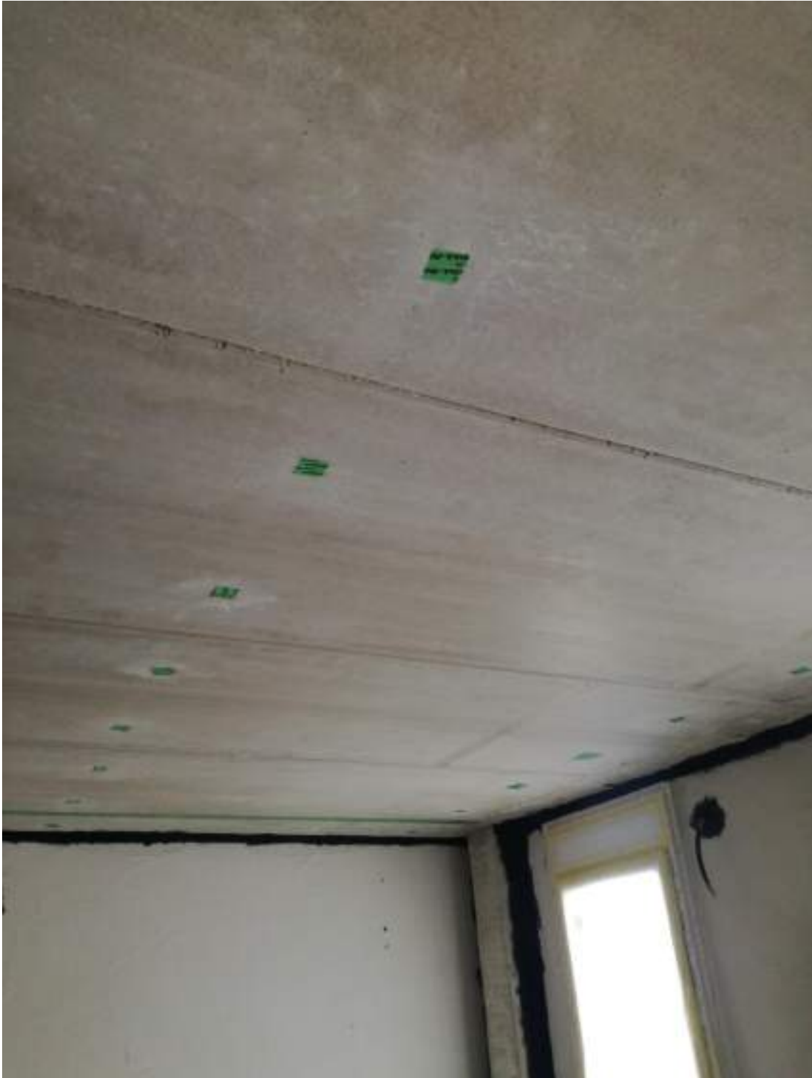
Ilustración 7 Prelomas pretensadas PRZ vna con junta vista sin tratamiento
