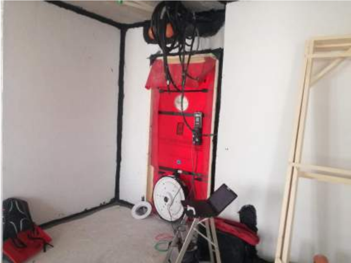
Ilustración 6 Dispositivo de medición instalado en hueco acceso vivienda
